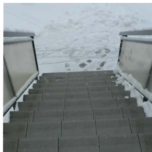
funkce topných kabelů ve venkovním schodišti
