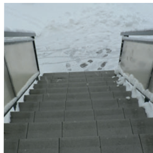
funkcia vykurovacích káblov vo vonkajšom schodisku
