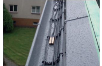
instalace topných kabelů a vlhkostního čidla ETOR v okapovém žlabu
