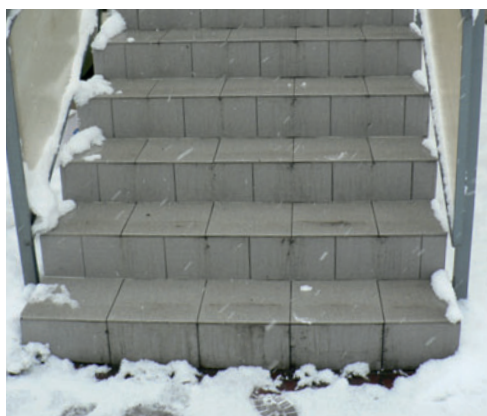
vyhřívání schodiště, Ostrava
