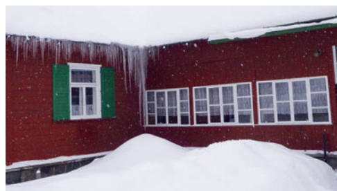
zátěží sněhu stržený okap (rohová část chybí), Dolní Dvůr
