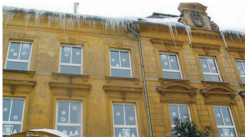
nebezpečné rampouchy u veřejných chodníků, základní škola, severní Čechy
