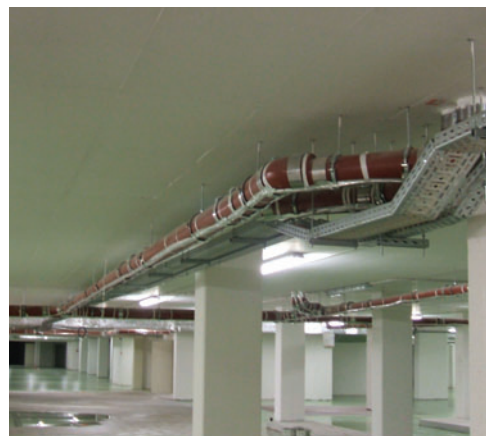
vyhřívání podstropní rozvody v nevytápěných podzemních prostorách, rezidenční komplex Central Park Praha
