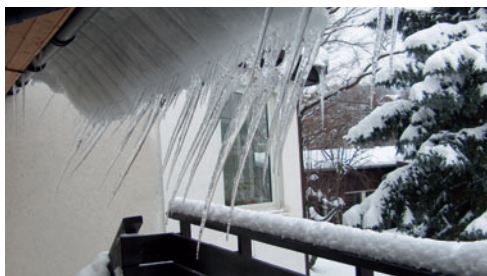
neprůchodné a přetížené okapové žlaby, Valašské Meziříčí
