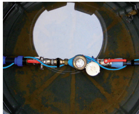
šachta na vodoměr na hlavním přívodu pitné vody
