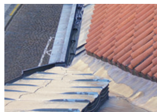
střešní žlab chráněný topným kabelem
